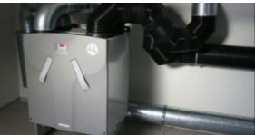
Foto: Tom Bleys Woningventilatie
